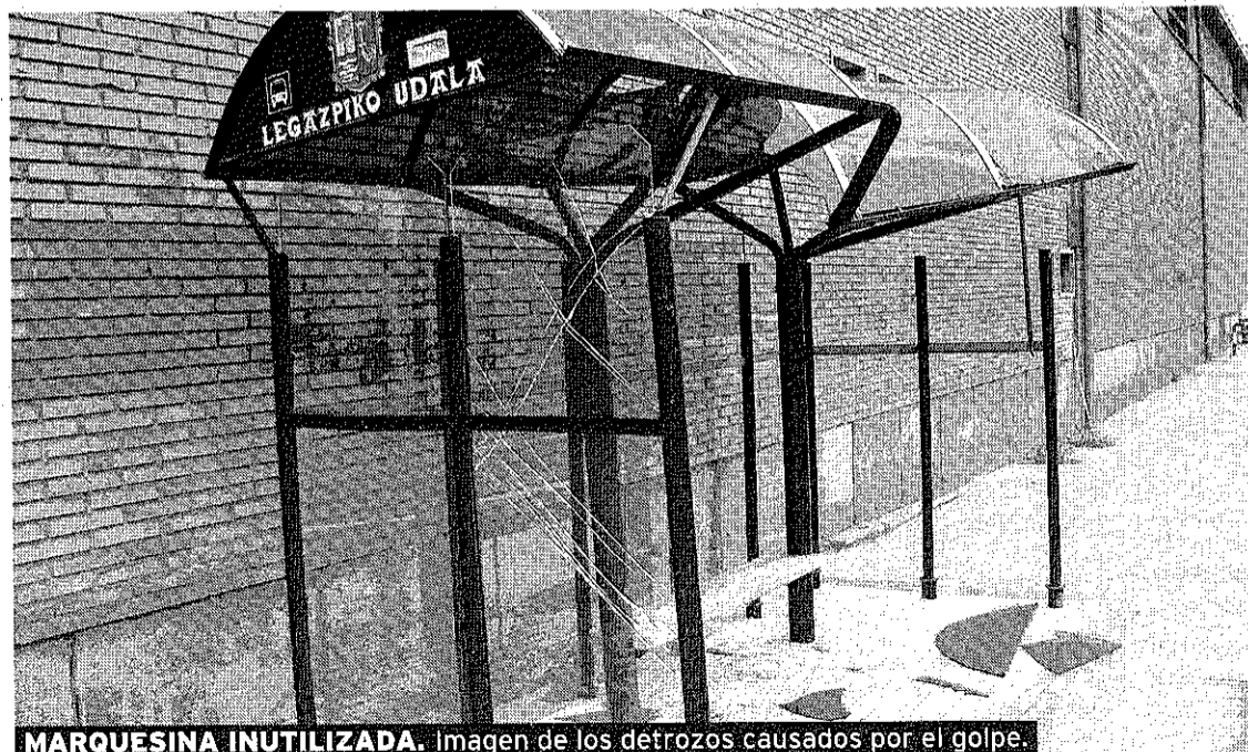
MARQUESINA INUTILIZADA. Imagen de los destrozos causados por el golpe.
